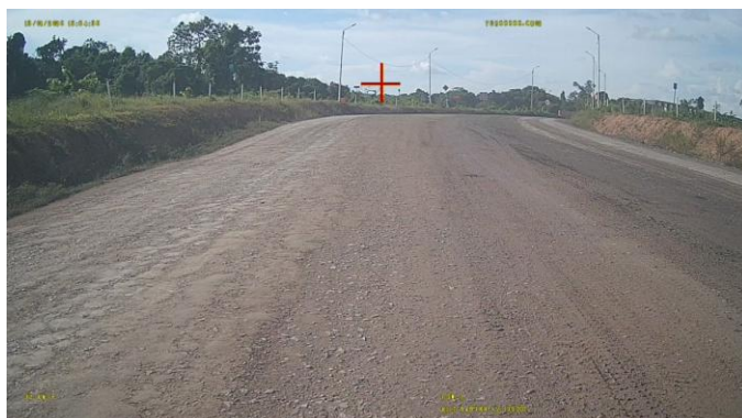
Gambar 1. Posisi Kamera DMS Channel 1 yang Benar
